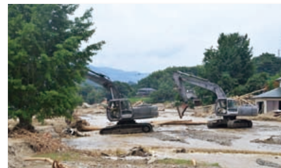
写真-7 行方不明者捜索のため、赤谷川上流への施設器材の進入状況(福岡県朝倉市星丸地区)
