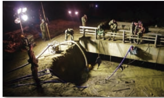
写真-12 投光器及び排水ポンプを使用した夜間の捜索活動状況 (福岡県朝倉市林田地区)
