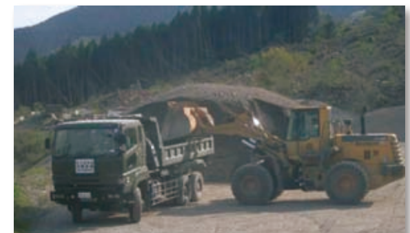
写真-4 熊本地震に伴う災害派遣状況 （南阿蘇地区における道路補修のためのダンプ作業）
