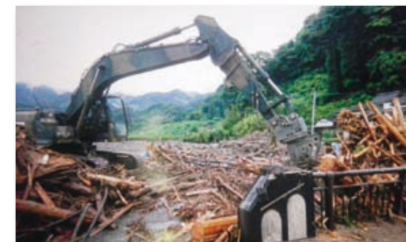
写真-8 グラブプルを使用した行方不明者捜索のための流木の除去(福岡県東峰村)
