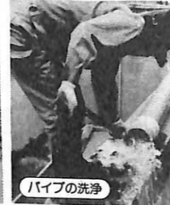
ビル高所揚水/飲料水用
